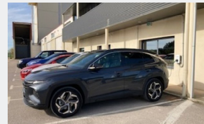
Ilustración 10. Cargadores para vehículos eléctricos en Almoguera.
